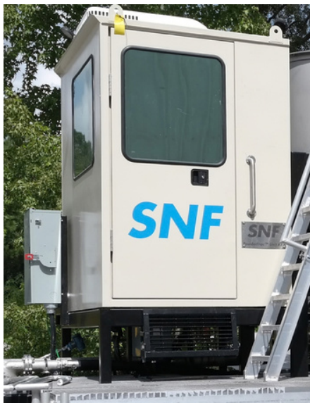
Cabina de control
